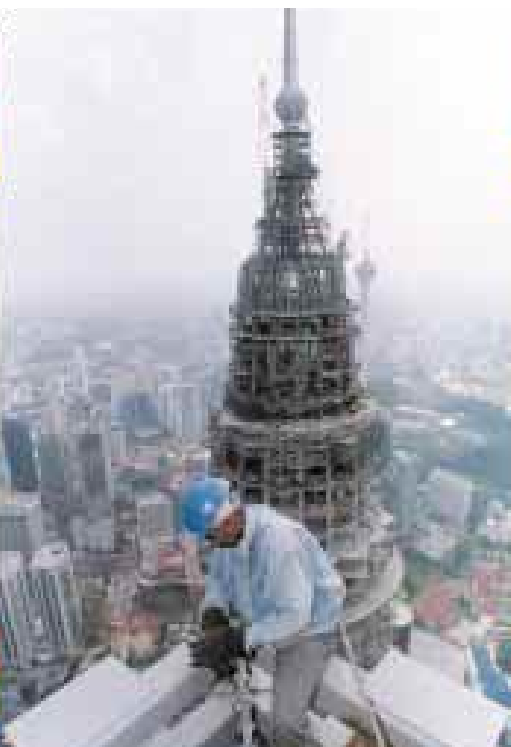
The Petronas Twin Towers i Kuala Lumpur i Malaysia, som ble ferdig i 1997, er med 451 meter verdens høyeste bygning. Til konstruksjonen medgikk det blant annet 428.000 m 3 betong. Borregaard LignoTech leverte ligninbaserte dispergeringsmidler av typen Borresperse til betongprodusenten. Borresperse gjør det mulig å redusere sementmengden i betongen samtidig som man får jevnere støp. Betongmixen blir i tillegg mer smidig og kan pumpes selv til store høyder. Vanninnholdet i betongen kan også reduseres. Resultatet er sterkere konstruksjoner.
